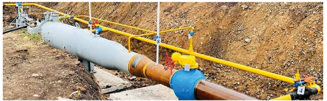
Универсальный мобильный комплекс запуска в процессе обследования МГ Магнитогорск-Ишимбай
